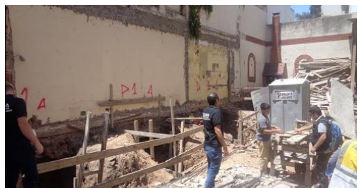
Excavaciones y fundaciones. Esta etapa presenta gran riesgo en las construcciones linderas que pueden verse agravadas por lluvias (socavación de suelos).
